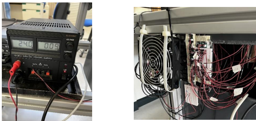
Figura 2.29 Fuente de alimentación utilizada para el ventilador y disposición del ventilador
